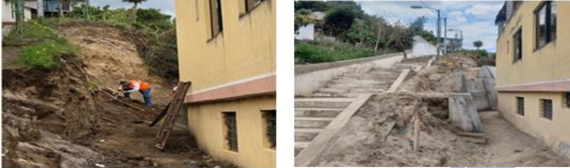
Construcción muro de protección de la obra escalinata pasaje turístico La Herrería, en el barrio La Escalera en la parroquia Perucho
