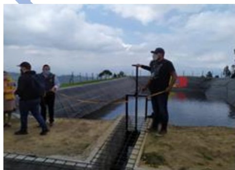
Desarenador e impermeabilización de reservorio del Sistema de Riego Molino Alto, parroquia El Quinche, cantón Quito.
