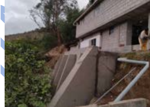
Construcción de muro y revestimiento de tramo crítico. Canal de riego Pueblo Viejo, parroquia Guayllabamba, cantón Quito
