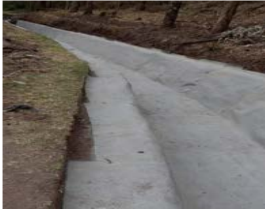
Revestimiento con manto geosintético (manto de hormigón), mejoramiento del canal principal y ramales del sistema de riego Tumbaco, cantón Quito
