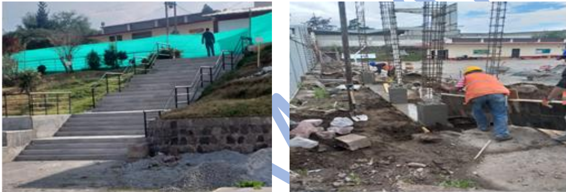
Construcción de un muro, graderíos y pintura exterior en la Unidad Educativa Pomasqui
